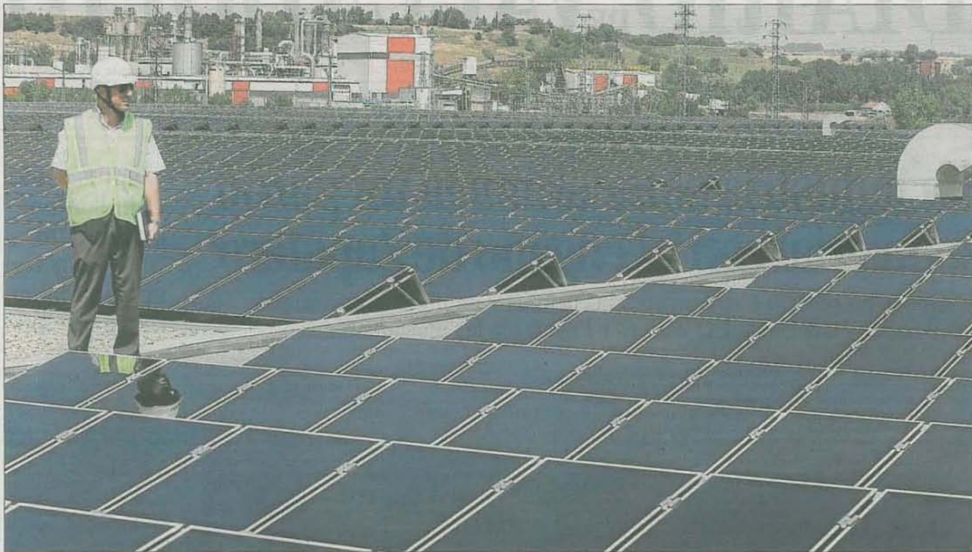
Campo de placas solares instalado en una factoría de Valladolid. / ICAI
